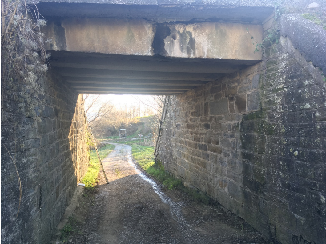
Slika 3: Obstoječi podvoz – pogled spodaj. Vidno je zamakanje med kasneje izvedeno razširitvijo ter starejšo konstrukcijo. Zaradi omenjenega sta oba robna AB nosilca zelo dotrajana in poškodovana.
