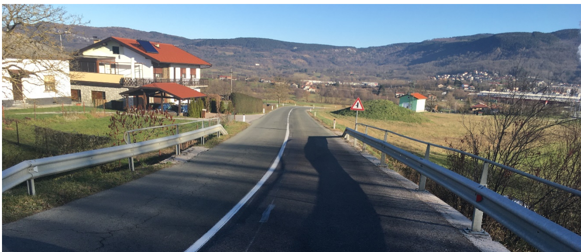
Slika 2: Obstoječi podvoz – pogled iz regionalne ceste. AB razširitev na kateri je JVO je kasnejše izvedbe.
