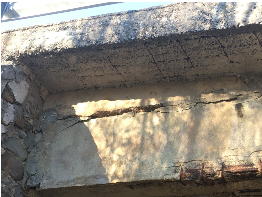
Slika 4: Obstoječi podvoz – pogled na rob prekladne plošče. Opaziti je razpadajoči beton in korodirana armatura starejšega dela konstrukcije ter nekvalitetno izvedena razširitev.
